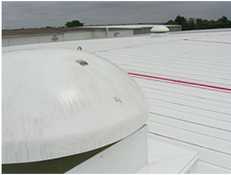
廃熱用電動ルーフファン
