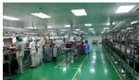
カシオタイ工場のLED照明
