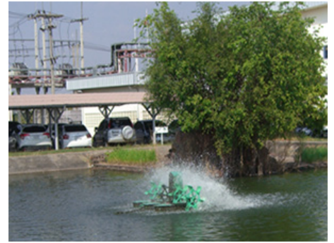
貯水池の空気取込用攪拌機
